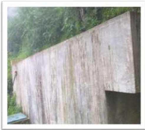
Imagen 16. Estructura de retención de sólidos
