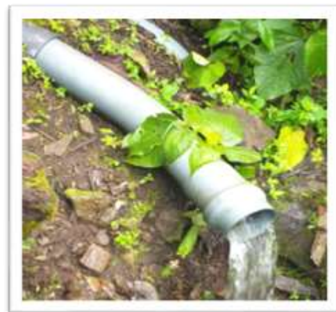
Imagen 17. Falla de válvulas.
