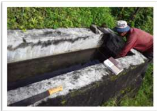
Imagen 18. Sistema de tratamiento de agua.
