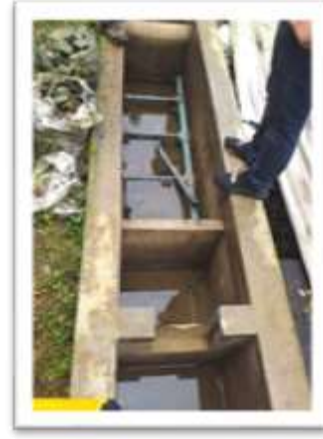
Imagen 25. Sistema de tratamiento.
