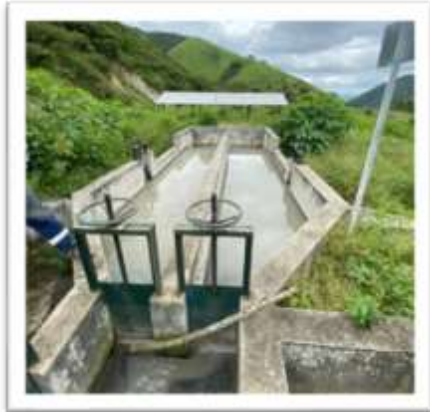
Imagen 26. Planta de tratamiento de aguas residuales.
