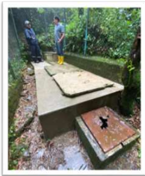
Imagen 22. Planta de tratamiento.
